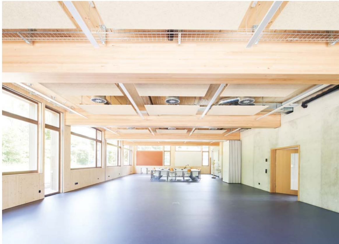
Les grosses poutres gênent les installations techniques.
